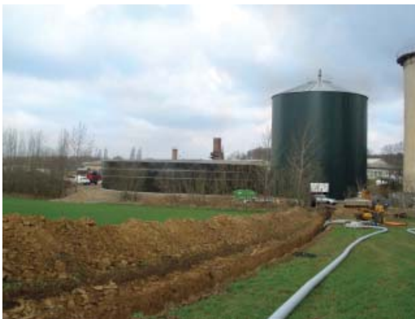
Obr. 2: Potrubí pro odvádění tepla ze zařízení na výrobu bioplynu určeného pro vytápění školy
